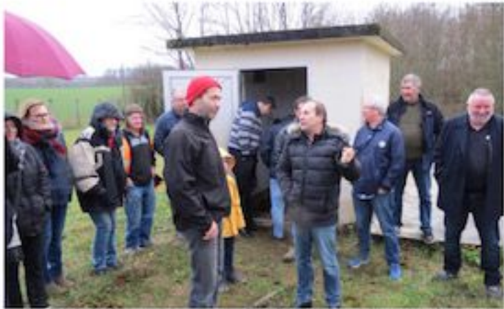
Toutes les personnes ayant œuvré à la vie du syndicat étaient conviées samedi matin pour une visite guidée de la station de pompage. Photo Ch.L.
