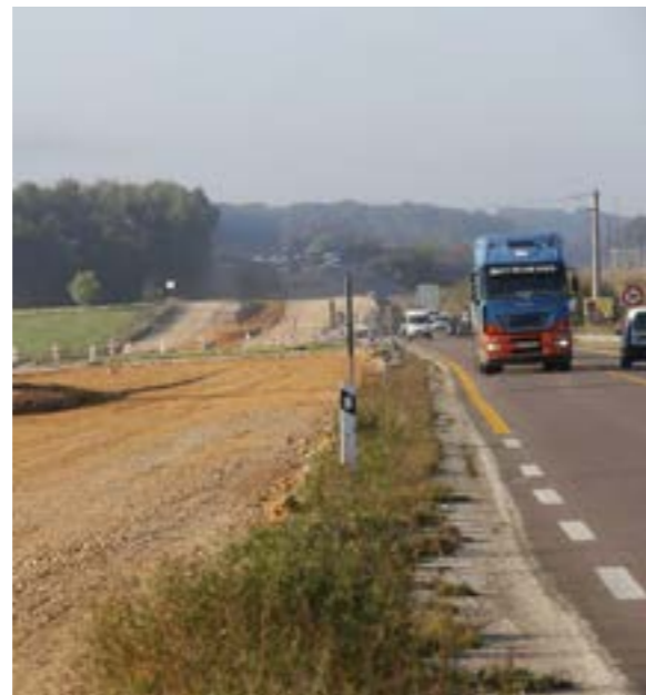
La mise à 2x2 voies de la RN 57 entre Voray-sur-l'Ognon et Rioz devrait être achevée en deux temps, avec une première mise en service prévue fin 2017. Photo Bruno GRANDJEAN
