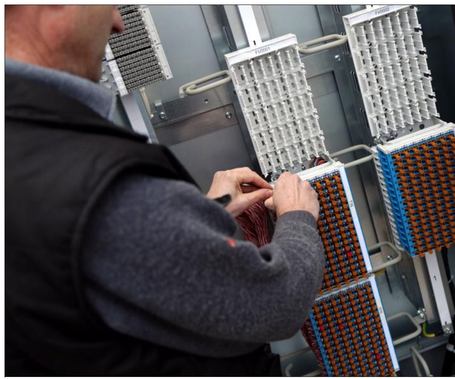
■ La mise en service des armoires de montée en débit internet a débuté en décembre et va se poursuivre en 2016. La fibre optique se rapproche des habitants. Photo Sam COULON
